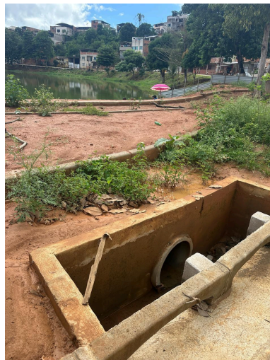
Boca coletora da drenagem Autoria: Thaís Calhau Data: 26/03/2026
